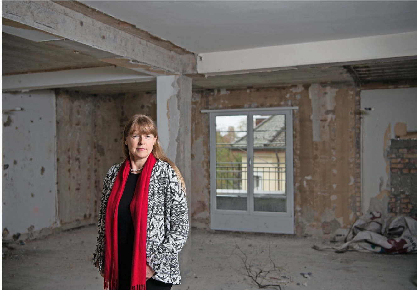
Raum für Frauen: Irène Meier, Präsidentin der Frauenhotel AG, auf der Josephine's-Baustelle. Foto: Doris Fanconi
